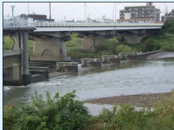
(右岸側) 転倒ゲート×4基
