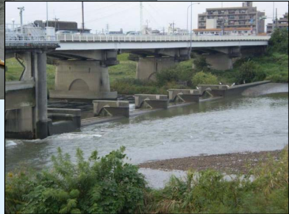
(右岸側) 転倒ゲート×4基
