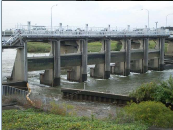
(左岸側) 巻上ゲート×6基
