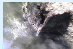
矢板欠損部の空洞化
