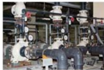
▲堀留水処理センターのヒートポンプ
