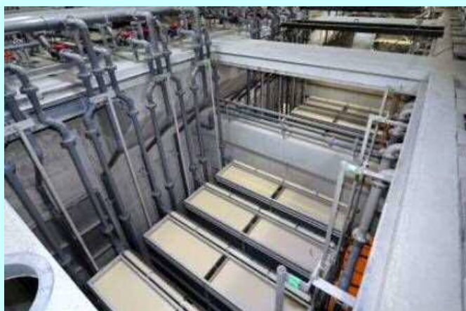
好気タンク内の 平膜ユニット
