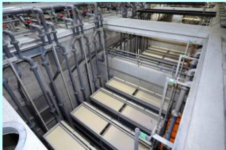
好気タンク内の 平膜ユニット
