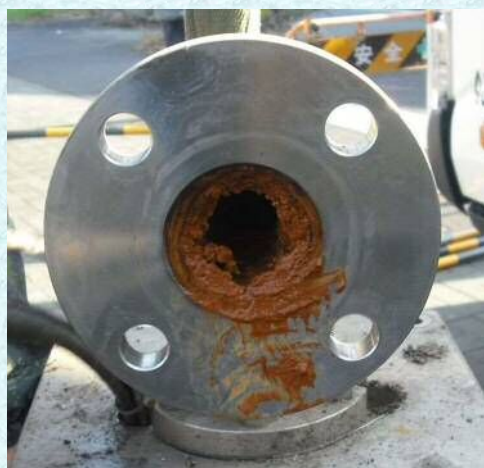
管内の付着状況
