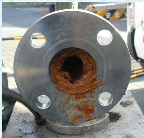
管内の付着状況
